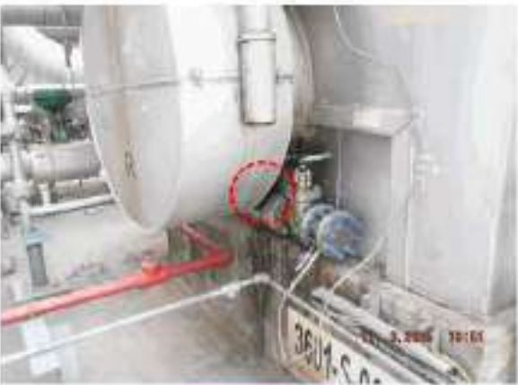
ภาพที่ 30 อุปกรณ์ 3601-S-001R ปัญหา Tag.E-66-06-0055: Flange Stud Bolt & Nut เกิด Corrosion (ClassB)
